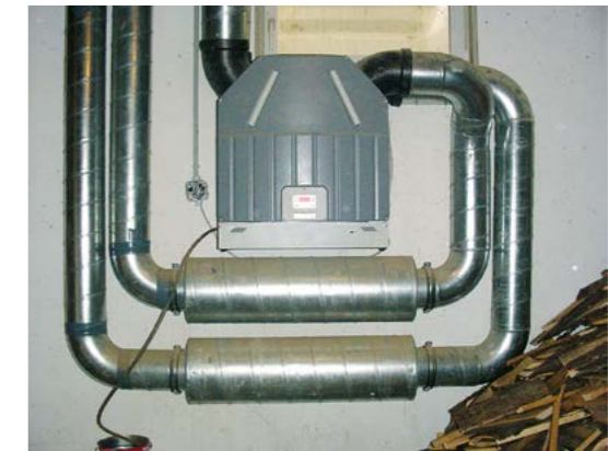
Abb. 44 | Lüftungsgerät mit Wärmetauscher und Schalldämpfer
