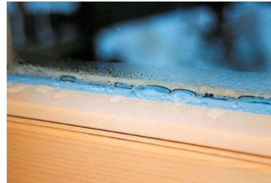
Abb. 20 | Kondenswasser im Randbereich bei Fenstern mit Glasrandverbund aus Aluminium
